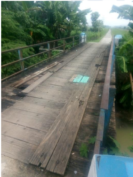
Salah satu kondisi jembatan di dusun Cikalong
